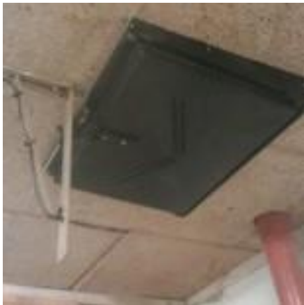
Figur A1. Klimakammer med både gulv- og loftsudsugning.
